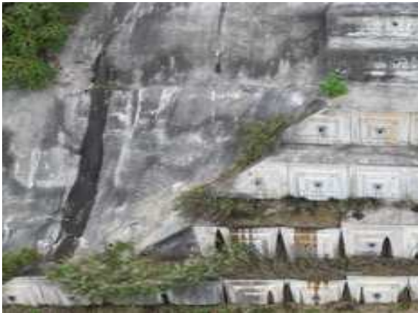
주변영향인자(절토사면부, 배수시설) 숏크리트 내부 토사유실
