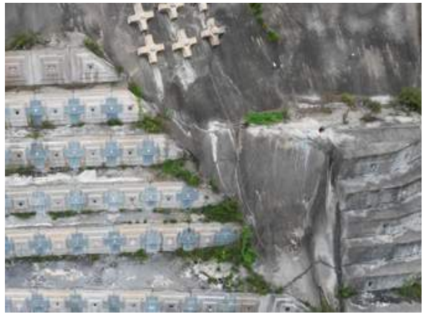
주변영향인자(절토사면부, 배수시설) 숏크리트 파손
