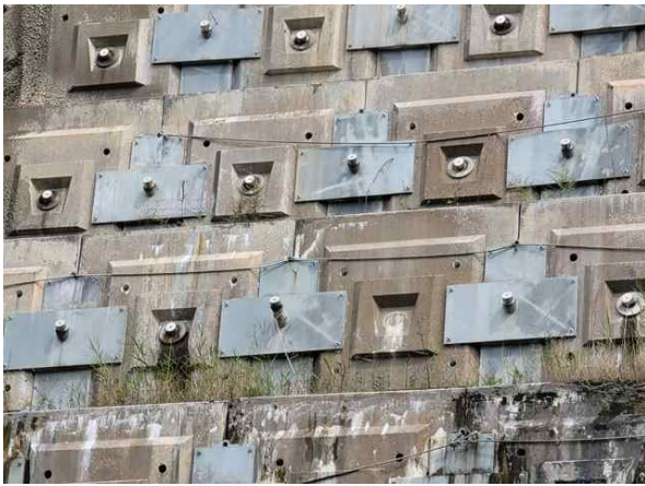
망상균열 및 백태
