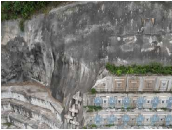
주변영향인자(절토사면부, 배수시설) 숏크리트 파손
